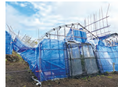
画像1 全損した園芸施設
