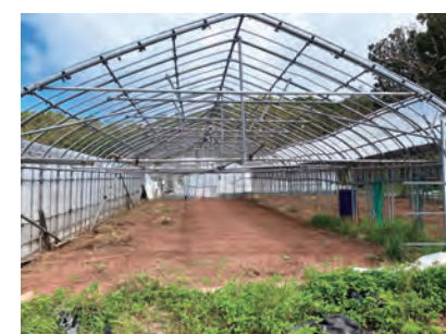
画像3 本体妻部分と被覆に被害を受けた園芸施設
